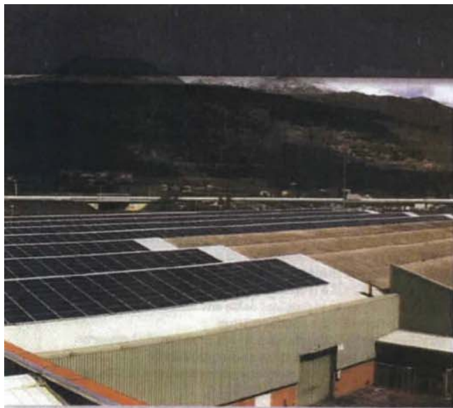
Impianto fotovoltaico da 1 mW della Mitsubishi a Impinato Celano
